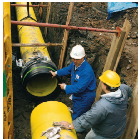
Соединение элементов газопровода при помощи больших муфт FRIALEN® диаметром 630 мм в Бирмингеме.
